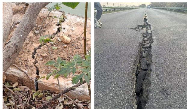
图2 挡墙及路面病害特征图
